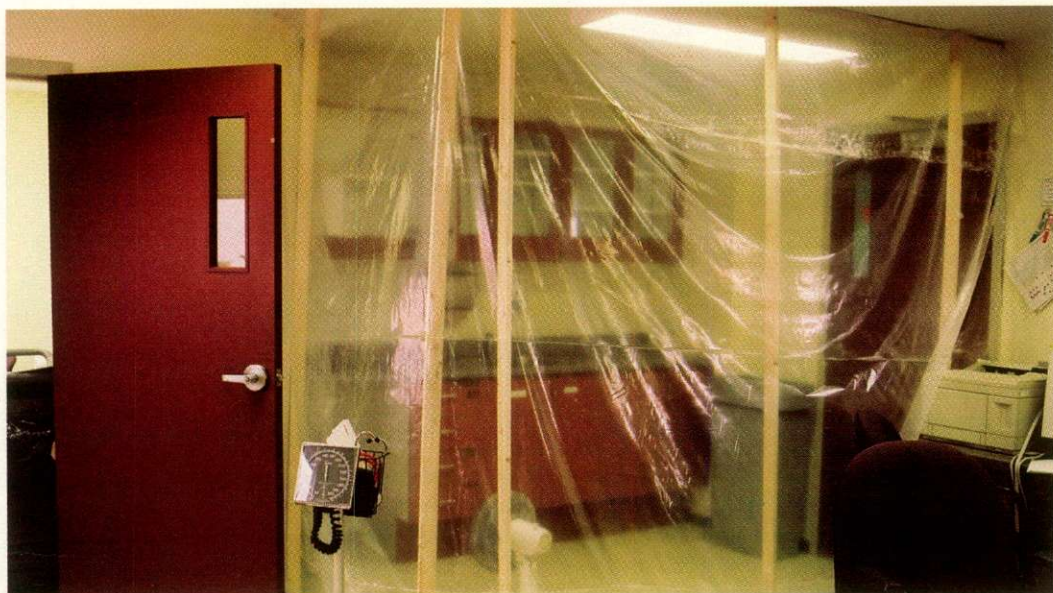
Plusieurs dégâts d'eau sont survenus au CHSLD-CLSC du Marigot, ce qui n'a rien pour aider au règlement des problèmes. Lors de notre passage, le 13 février, une partie d'un mur avait dû être démolie en raison d'une infiltration d'eau.
